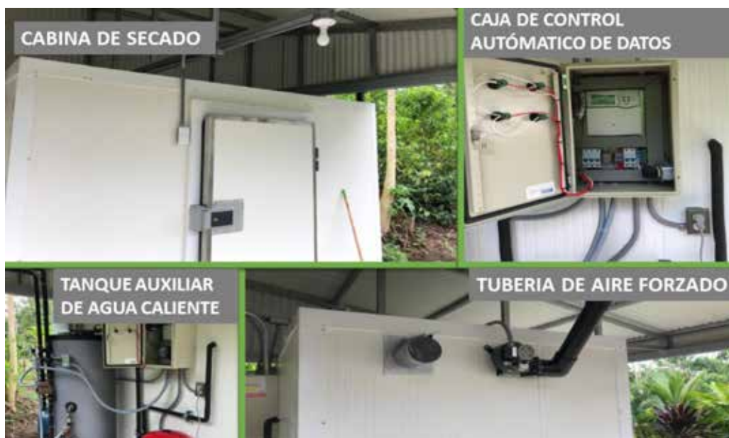
Figura 4. Sistema térmico solar activo híbrido forzado instalado.
