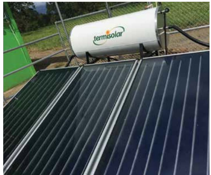
Sistema solar térmico termosifónico híbrido con resistencias eléctricas, instalado en la lechería de la Escuela Técnica Agrícola e Industrial de San Clara.
