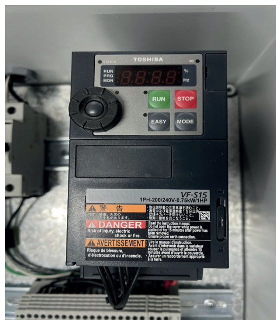
Figura 17. Variador de frecuencia TOSHIBA VF-S15.
