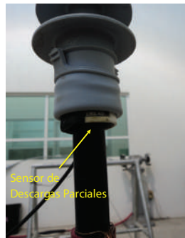
Figura 9. Colocación del sensor en el cuerpo de la terminal con falla.
