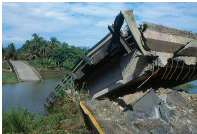
Figura 1. Efectos de licuación de suelos por el terremoto de Limón en 1991. Fuente: [2].
