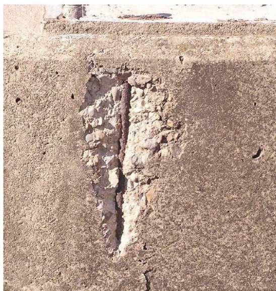
Figura 1. Carbonatación del concreto y consecuente descamado.
