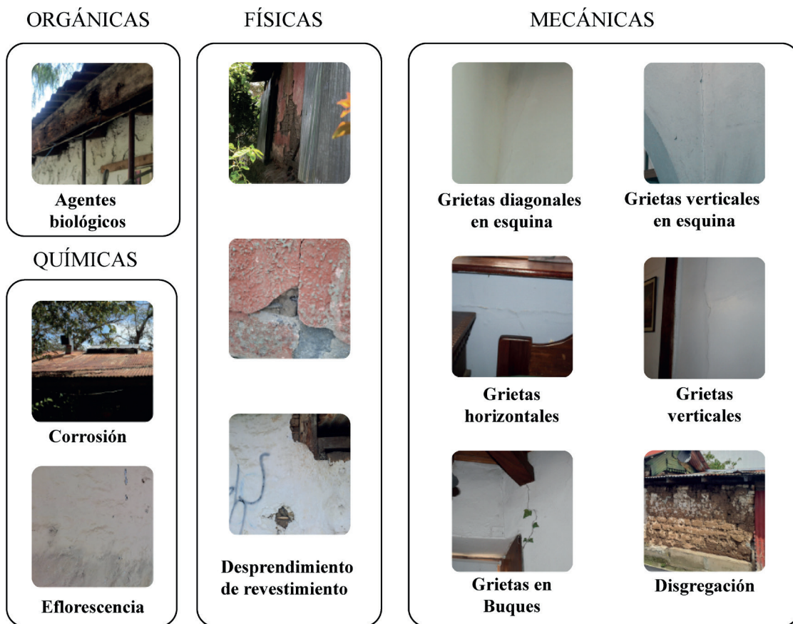
Figura 1. Principales lesiones identificadas e inventariadas en las edificaciones analizadas.
