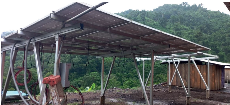
Figura 4. Paneles solares de la Escuela de Tolok Kichá. Fuente: [13]
