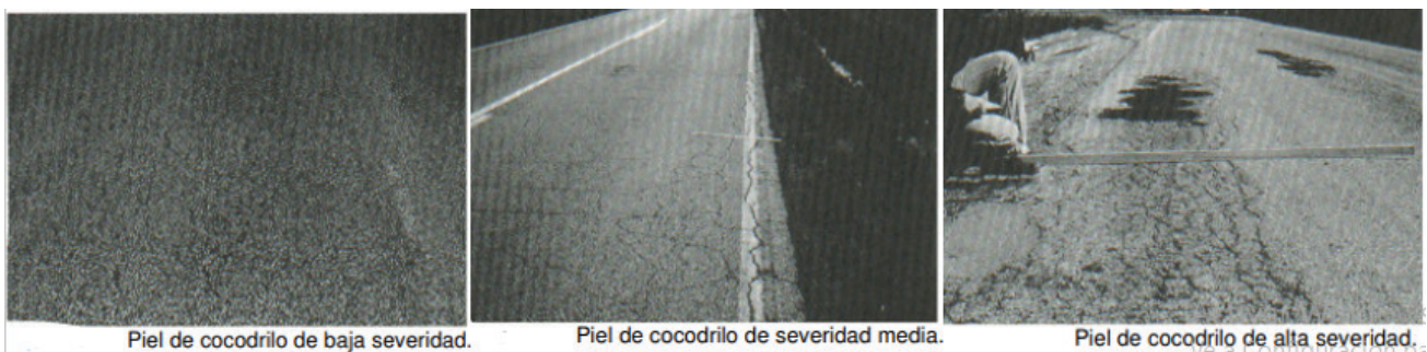
Figura 4. Niveles de severidad en piel de cocodrilo para carpetas asfálticas [16].
