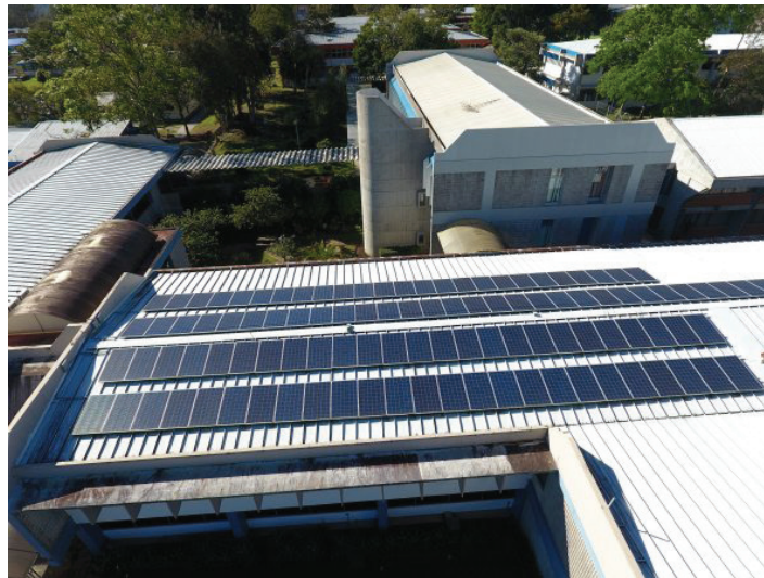
Figura 1. Sistema fotovoltaico conectado a red instalado en el Edificio A1 del Campus Central del Tecnológico de Costa Rica ubicado en Cartago, Costa Rica.
