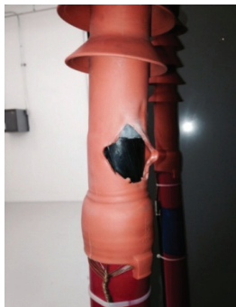
Figura 2. Ruptura de la cubierta de la terminal antes de una falla catastrófica.
