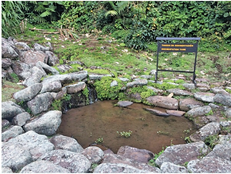
Figura 3. Tanque de sedimentación.
