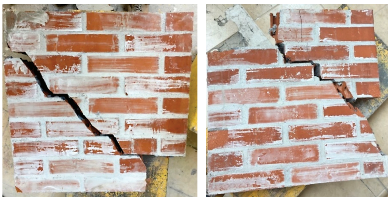
Figura 13. Modos de falla observados, falla por tracción diagonal (Izq.) y falla combinada (Der.).
