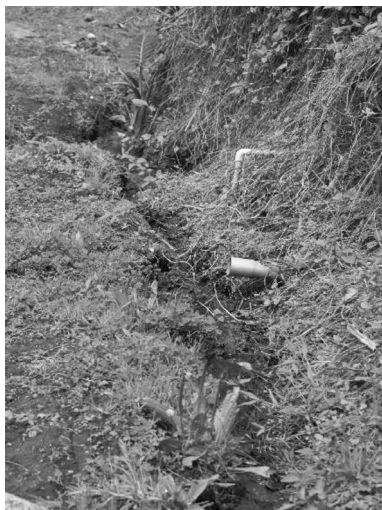
b) Vertido de aguas grises directamente en los terrenos
