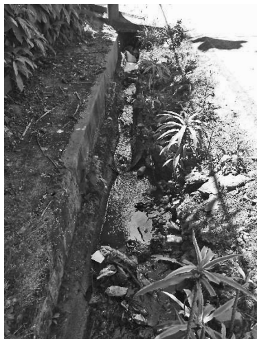
a) Vertidos de aguas grises en colectores de aguas pluvial
