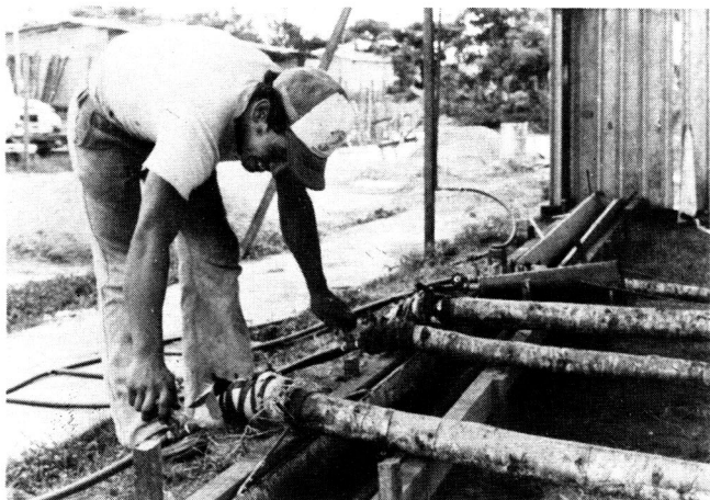
FIGURA No. 1. Postes acoplados a la tubería de presión. Nótese que el neumático está recubierto con gangoche o en cedazo plástico.
