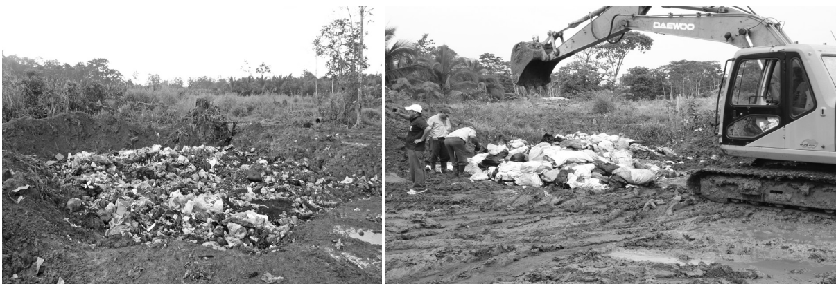
Figura 3. Fotografías del proceso de enterramiento de la basura en el vertedero municipal de Guácimo (tomada febrero 2013)
