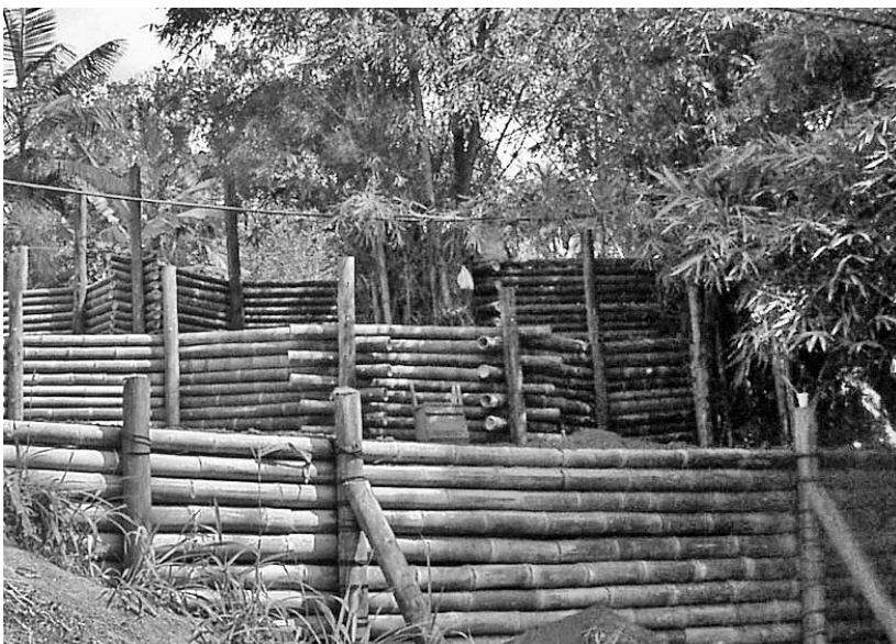
Figura 3. Muro de Guadua a tres niveles, soportados por postes y arriostres de madera.
