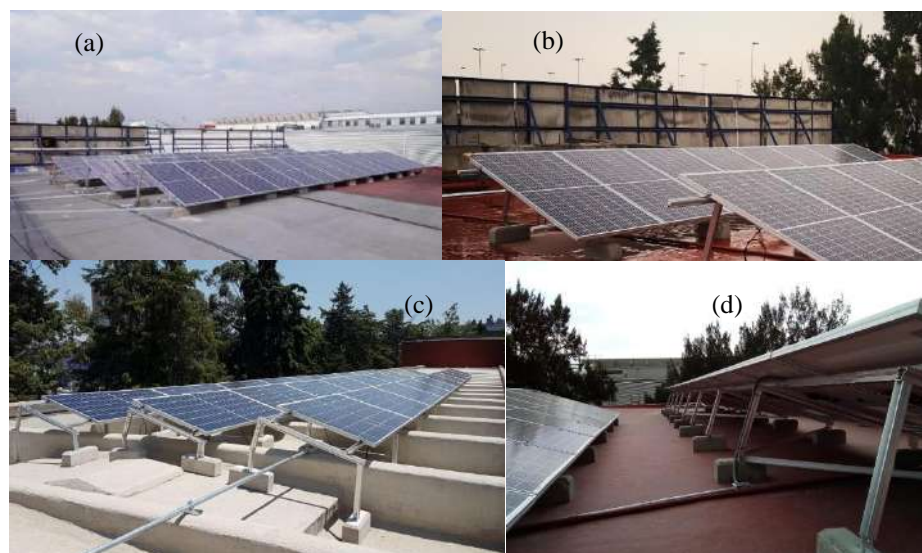
Fig. 6. Solar FV system installed at (a) EART, (b) CICO, (c) CNM, (d) EDIS.
