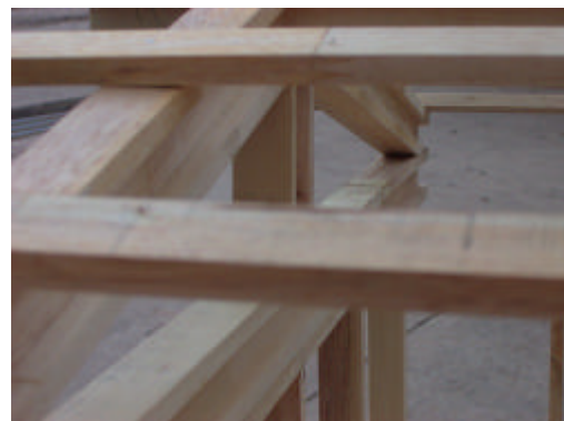
Figura 7. Vigas de perfil I de madera de Terminalia amazonia utilizadas como cerchas en una casa.
