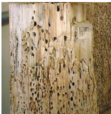
Daño en postes de un muelle causado por moluscos (Fotografía: Edwin Canessa)
