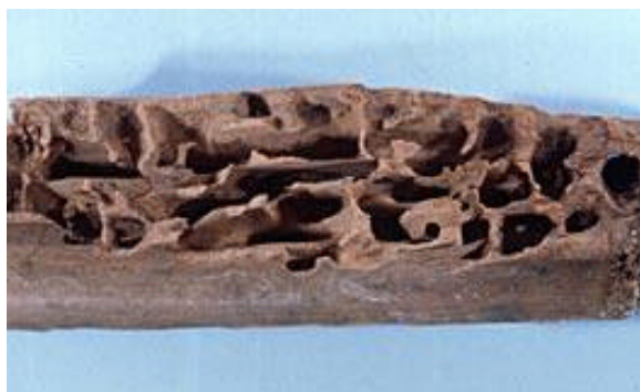
Daño en madera causado por Camponotus spp (Fuente: Grupp, SM., 2007)
