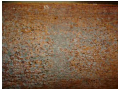
Presencia de moho sobre la madera (Fotografía: Alexander Berrocal)
