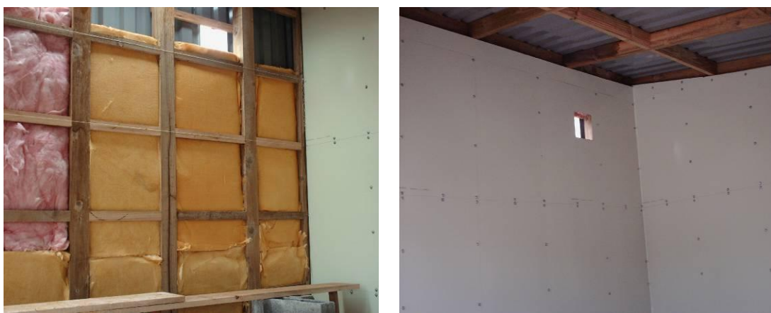
Figura 4. A la izquierda se observa el uso de la fibra de vidrio como aislante entre forros. A la derecha se observa la misma pared interna ya forrada internamente.
