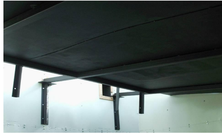
Detalle de soportes del colector y colector
