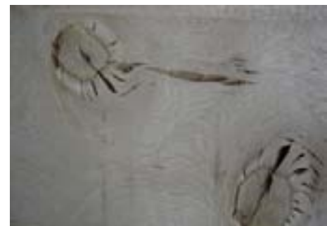
Presencia de rajaduras y grietas asociadas a nudos en madera seca
