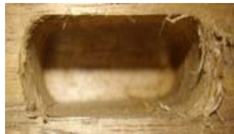
Fibra desprendida en el borde del orificio escopleado
