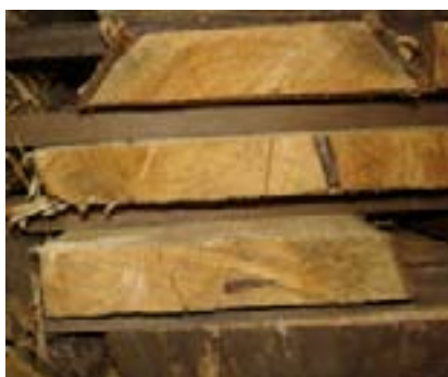
Presencia de rajaduras en los extremos de las tablas
