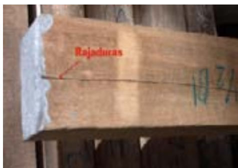
Rajaduras longitudinales y por cabeza en madera seca
