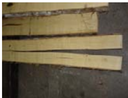
Rajaduras producidas por la presencia de la médula en la madera aserrada
