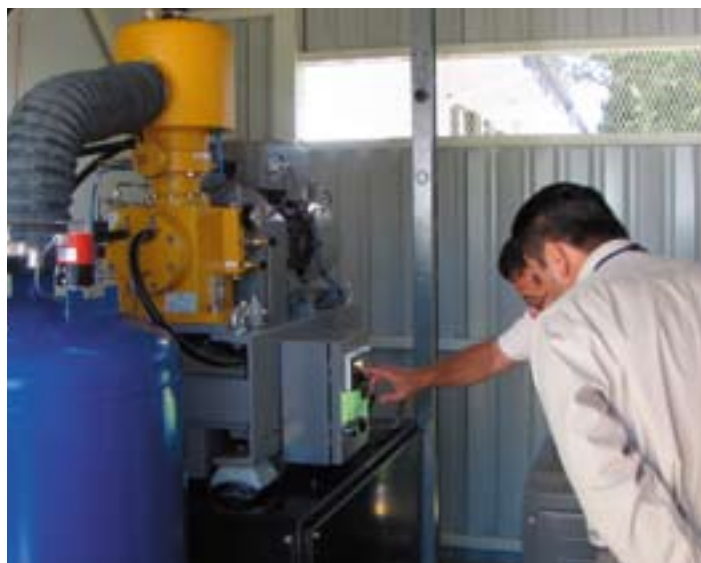
Planta generadora de nitrógeno líquido.
