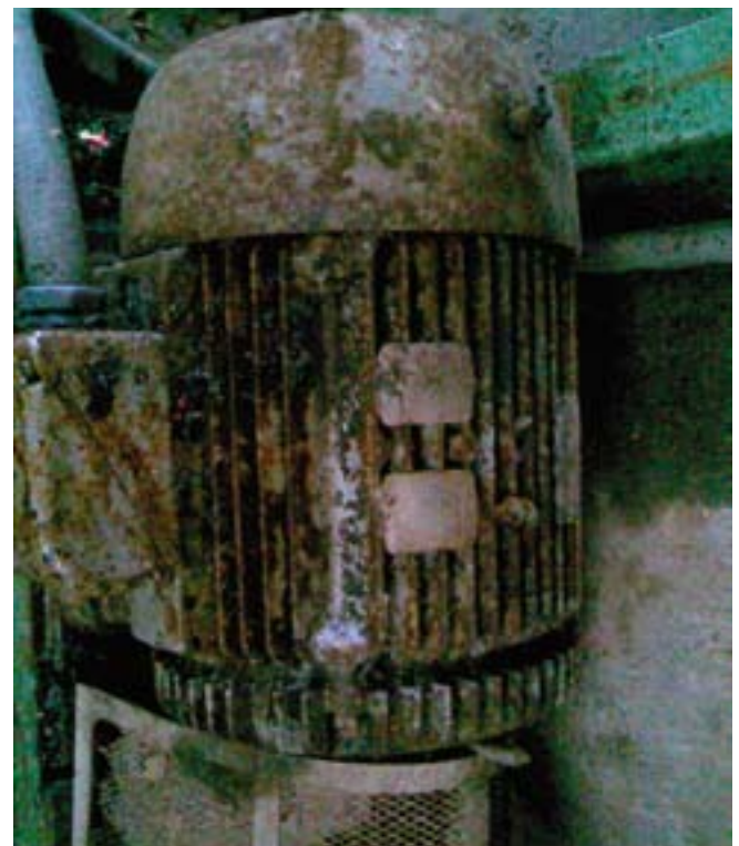
Bomba sumergible. Motor con problemas de humedad causada por condensación.
