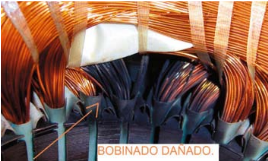
Motor con falla de corto circuito en el estator.
