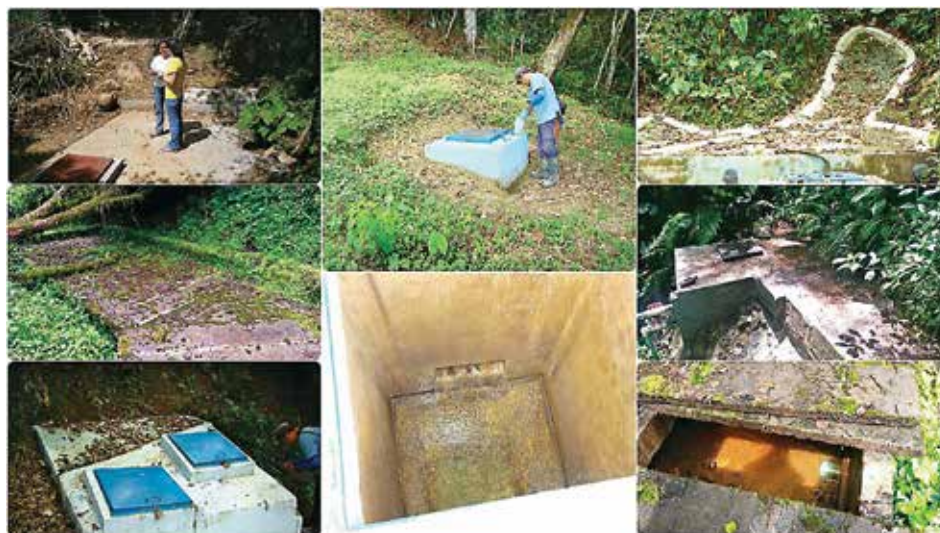
Figura 2. Estructuras hidráulicas de captaciones tipo nacientes.
